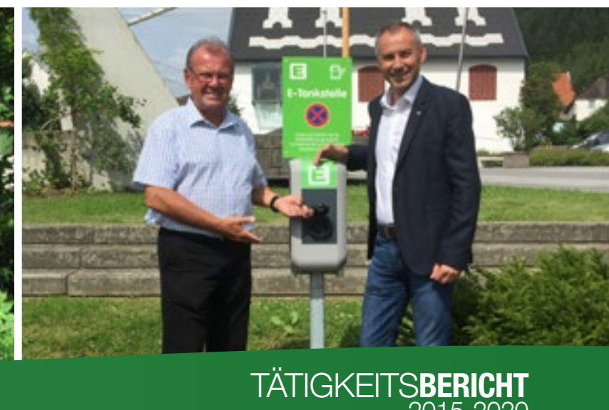
Zwei neue E-Ladestationen
