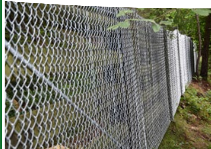
Steinschlagschutz bei der Gamswand
