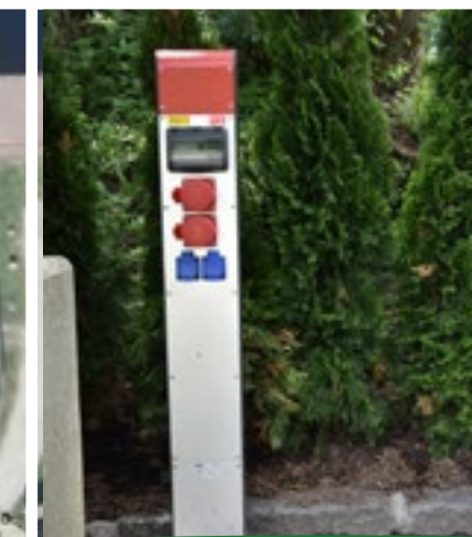
Stromanschluss im neuen Friedhof
