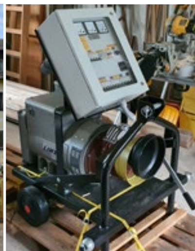
Notstromaggregat-Aufbau für die Traktoren im Fuhrhof
