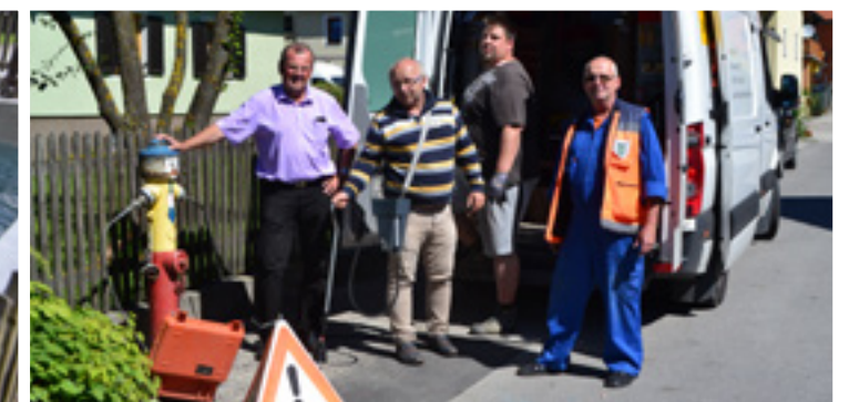
Wasserleitung-Fehlersuche durch Leckortung € 40.000,-
